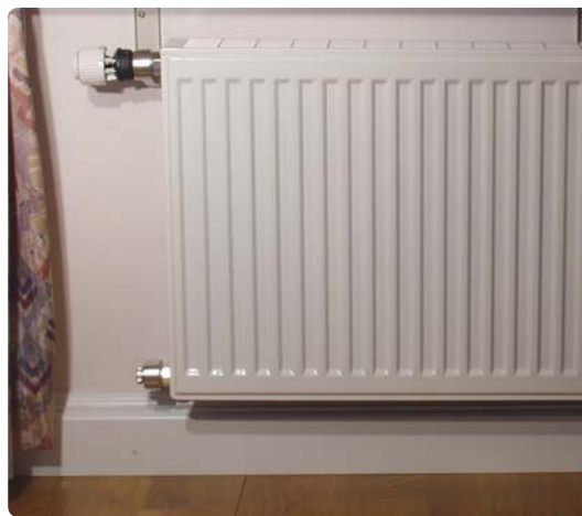
Tillopp- och returledning för värmedistribution
